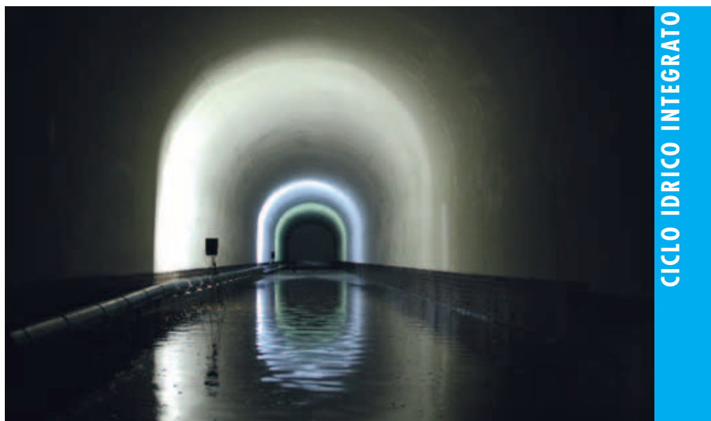
Serbatoio in galleria artificiale del nuovo acquedotto di Palermo
