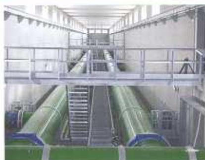
IL SERBATOIO DI MARZAGAGLIA
